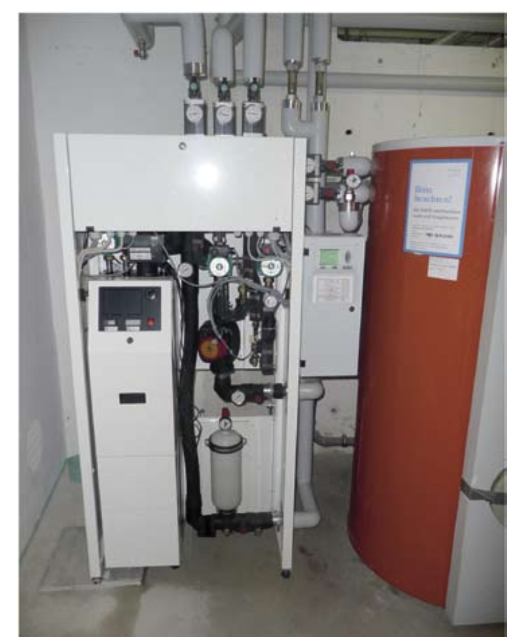
Herzstück: Die Wärmepumpe
